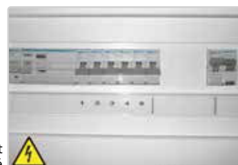
Intérieur du coffret électrique triphasé
